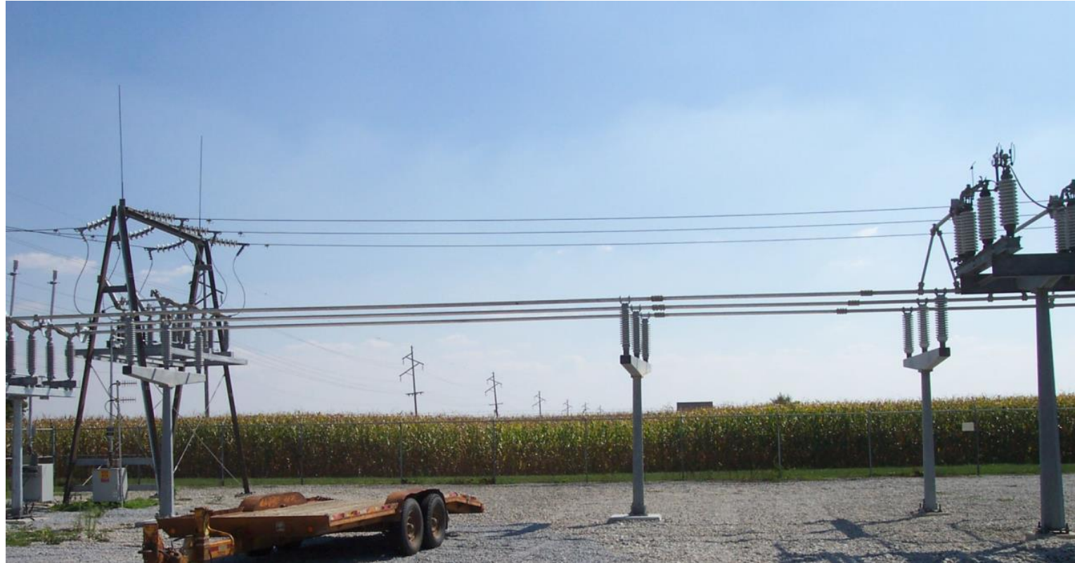
An actual substation bus
